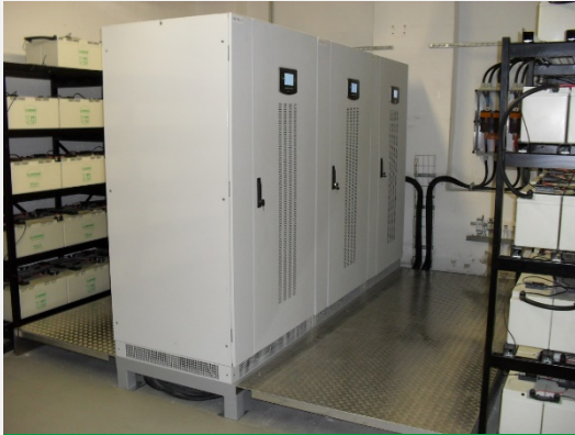
Data Center Telekommunikation
