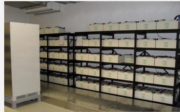
inkl. Schaltanlage mit Bypass
